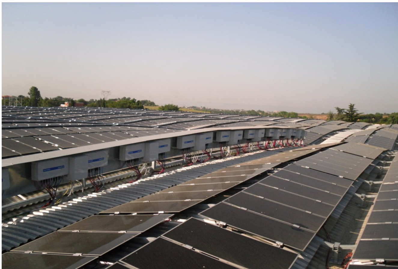
Pomezia ( Roma ) - Impianto 900 kw
